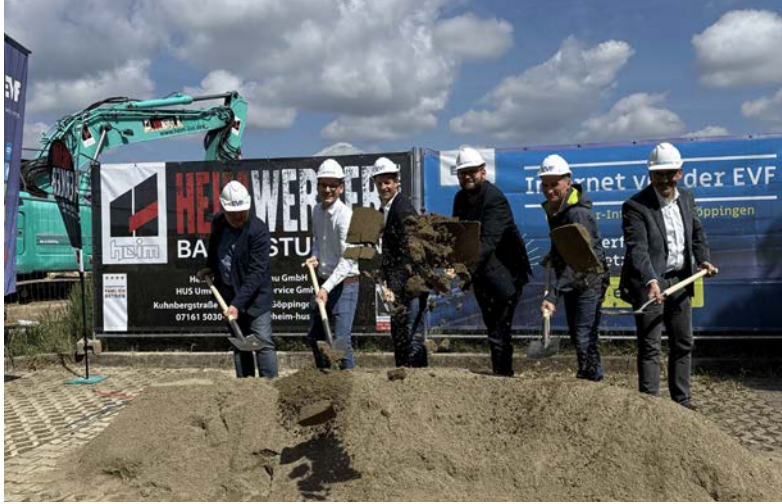
Am 8. Mai 2026 gab es den symbolischen Spatenstich für den Glasfaserausbau im Reusch.
